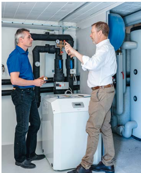
Energie-Coach Reto Niedermann (links) und Hausbesitzer Daniel Baumann (rechts) vor der neuen Erdsonden-Wärmepumpe im Keller, die das Gebäude ohne fossile Energien heizt. Bildquelle: Alex Buschor
