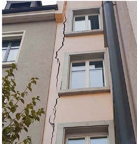
Riss in der Fassade: Ein Fall für die Gebäudeversicherung?
