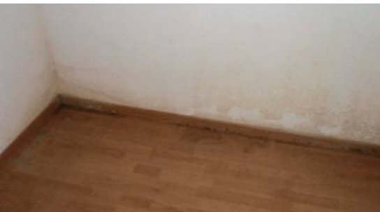
Schimmelpilzbefall an einer Aussenwand.
