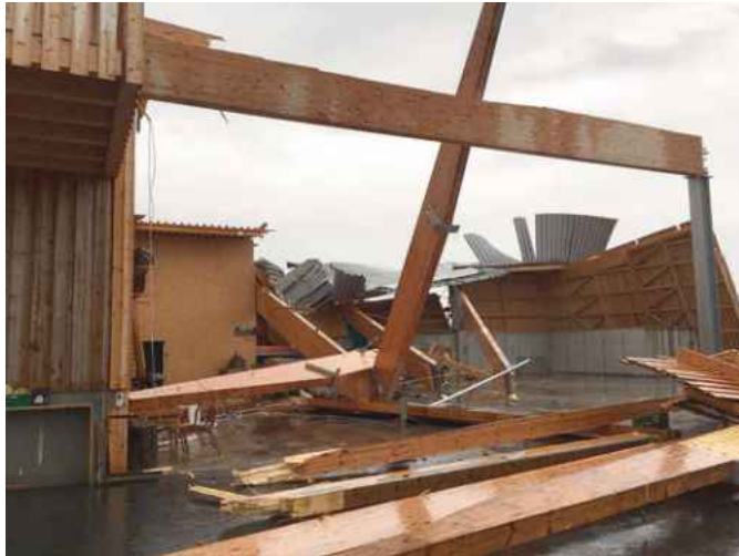
Heftige Böen brachten den Wagenschopf zum Einsturz.
