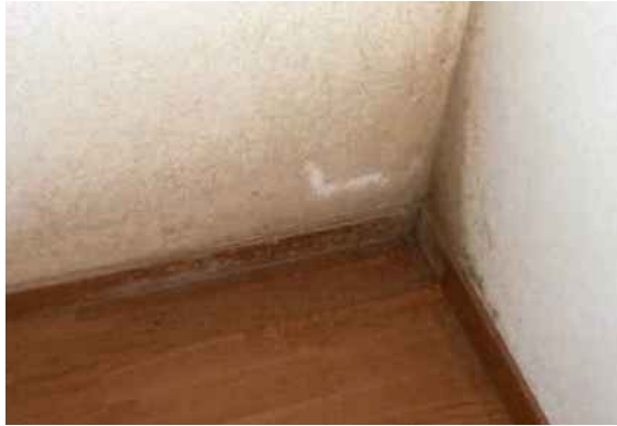
Typischer Schimmelpilzbefall an einer Aussenwand.
