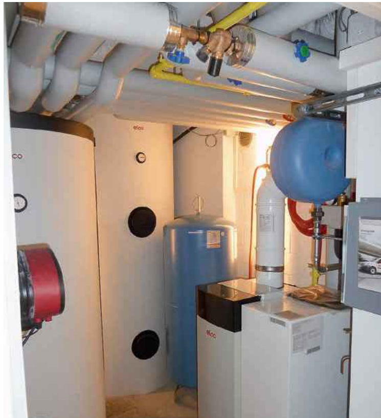
Neu erstellte moderne Heizungsanlage. (Bild HEV Zürich)
