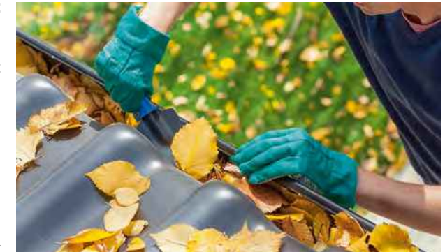
Dachwasserrinnen sollten im Herbst von Laub und Ästen befreit werden.
