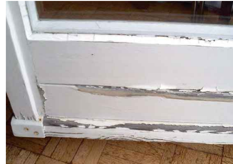
Die Balkontüre und das Parkett befinden sich in einem desolaten Zustand.
