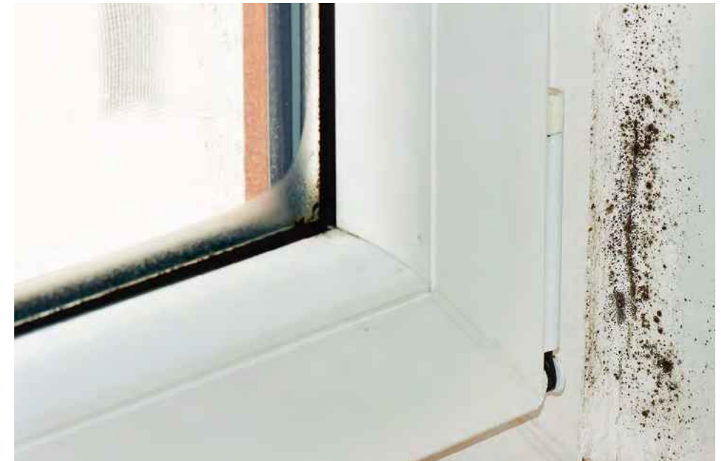
Fensternehe Bauteile sind besonders gefährdet.
