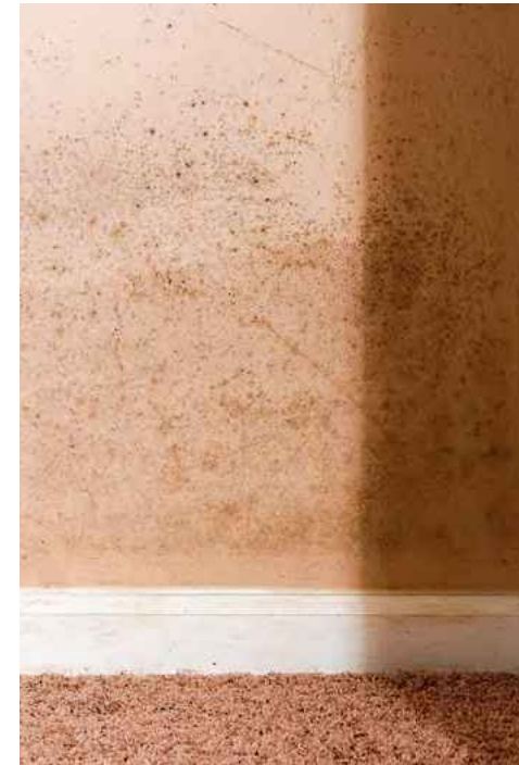
Grossflächiger Schimmelbefall an einer Wand.
