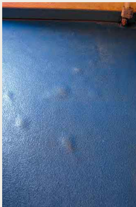
Bodenbeschichtung mit Blasen wegen eines undichten Leitungsanschlusses.
