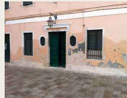
Putzabplatzungen wegen aufsteigender Feuchtigkeit.
