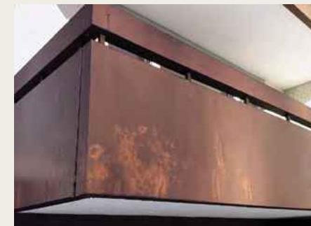
Beschichtungsverfärbung / Ausblühungen an einer Balkonbrüstung.
