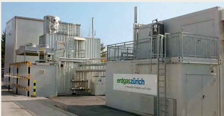
Erfolgreicher Betrieb einer Biogasanlage in Volketswil
